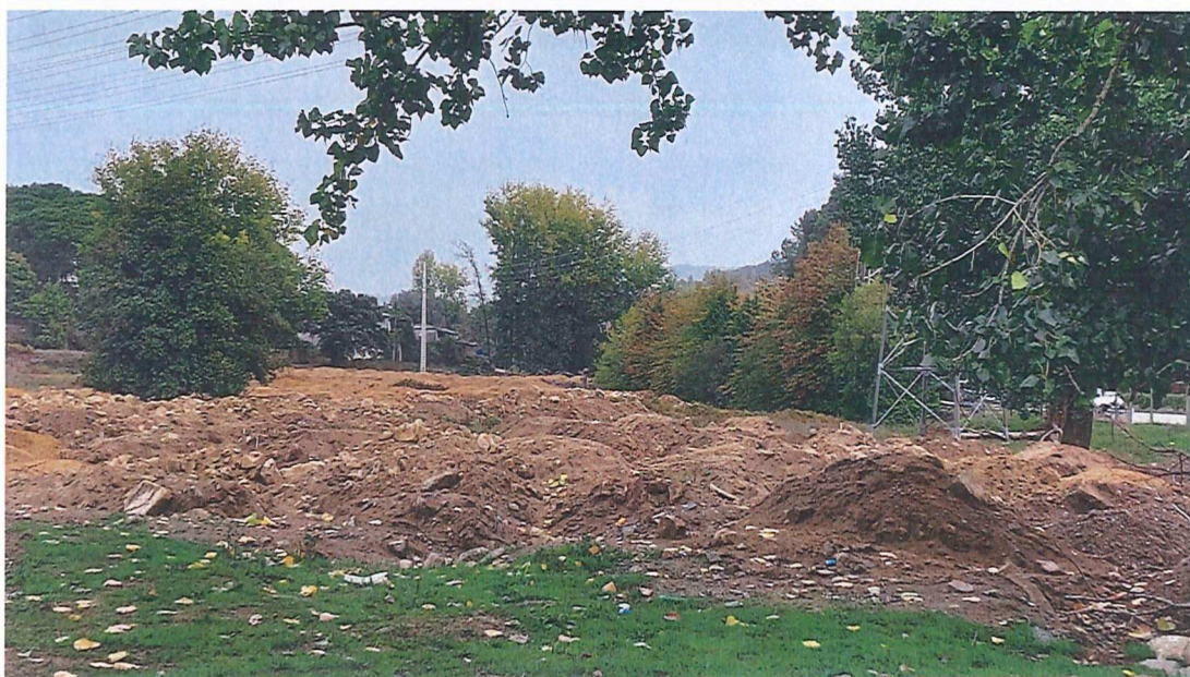
Foto 4 – Depósito de terras com alguma mistura de pedras soltas, numa zona a sul do terreno, próximo do edifício do McDonald's
