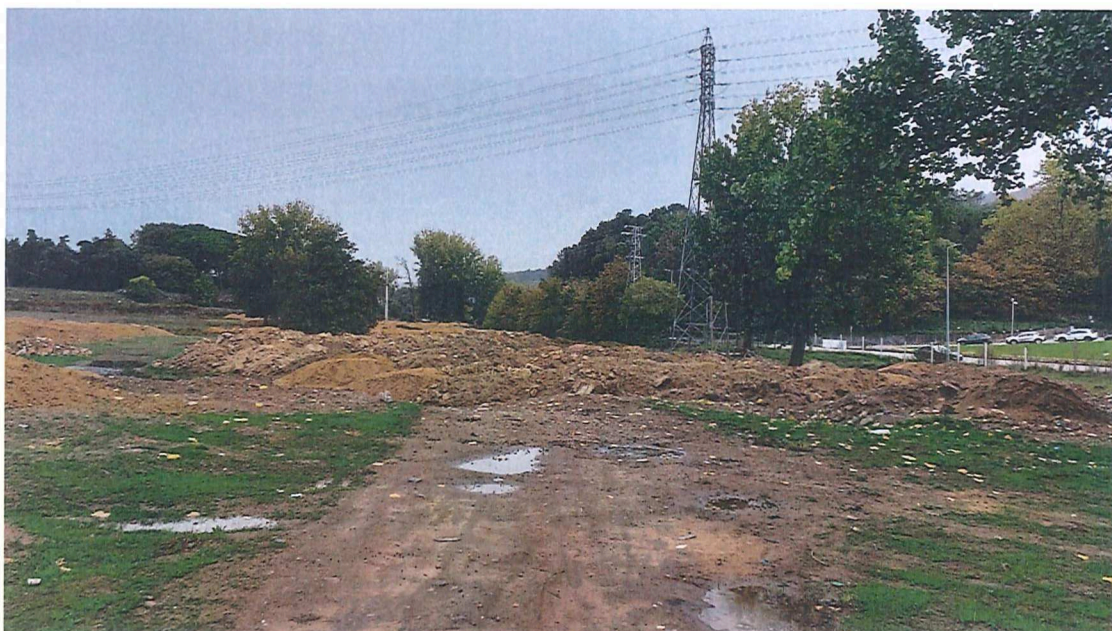
Foto 3 – Depósito de terras com alguma mistura de pedras soltas, numa zona a sul do terreno, próximo do edifício do McDonald's
