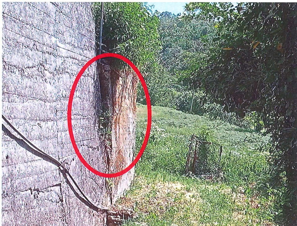
deslocamento na parte superior do muro.
