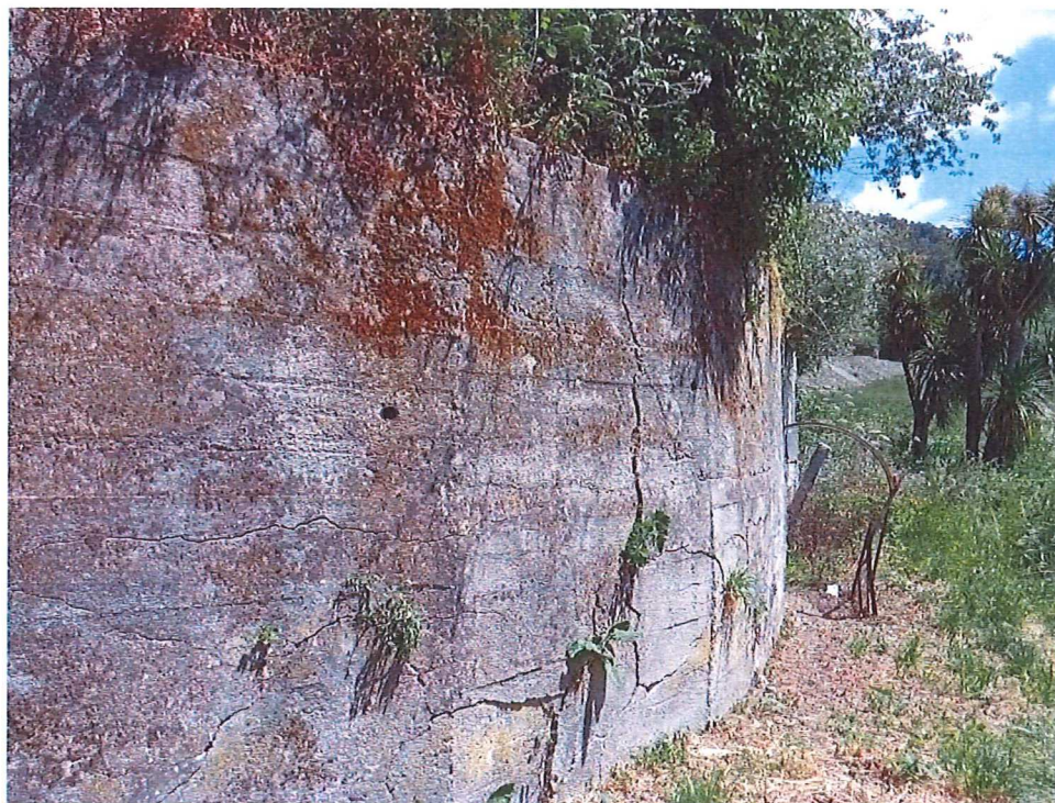
muro e deformação, "barriga".
