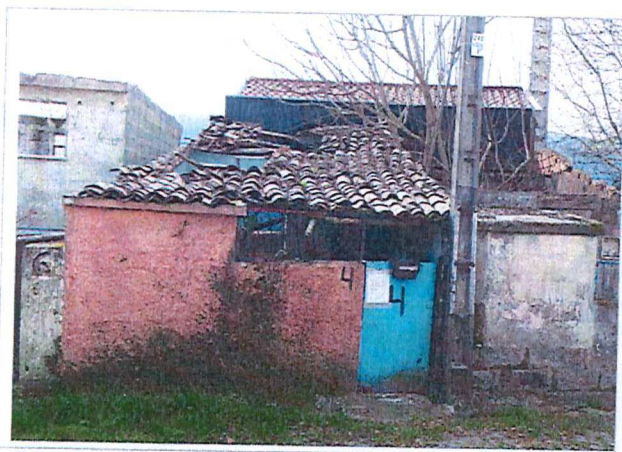
Cobertura em avançado estado de degradação ou em falta
