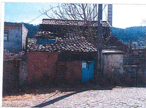
Existência de arbustos no logradouro da habitação
