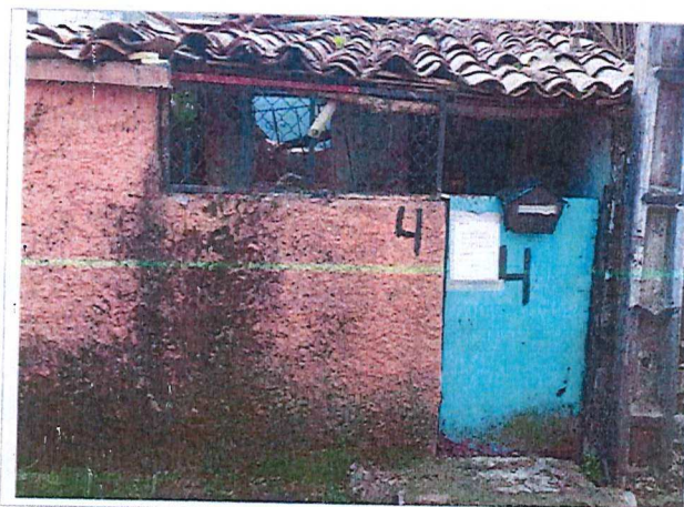
Beirais em telhas cerâmicas a ameaçar ruir para a via pública
