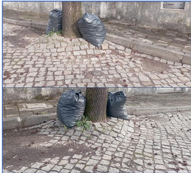
Figura 16 – Imagens de danos provocados pela árvore instalada no ID07
