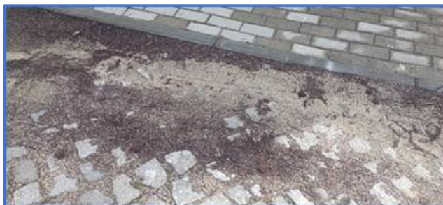
Figura 36 – Imagens do enquadramento da caldeira do ID18
