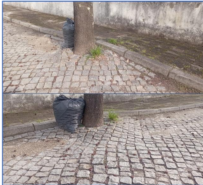
Figura 14 – Imagens de danos provocados pela árvore instalada no ID06
