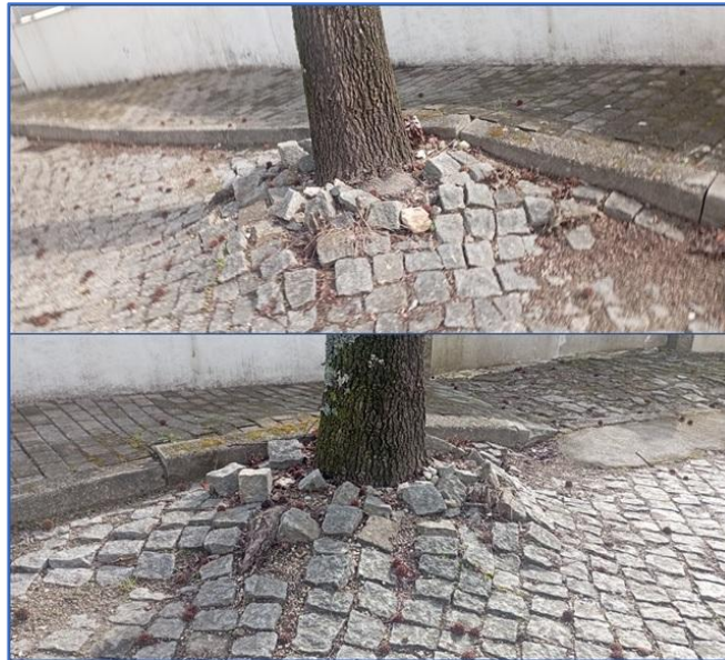
Figura 26 – Imagens de danos provocados pela árvore instalada no ID12
