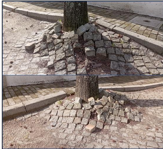
Figura 79 – Imagens de danos provocados pela árvore instalada no ID40
