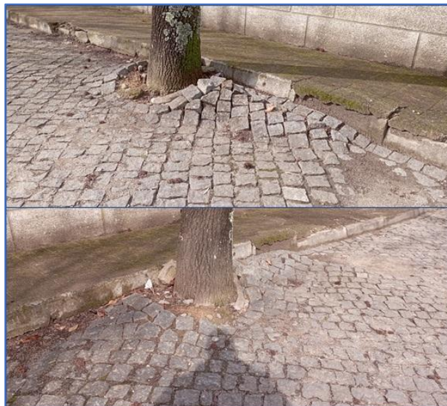
Figura 58 – Imagens de danos provocados pela árvore instalada no ID29
