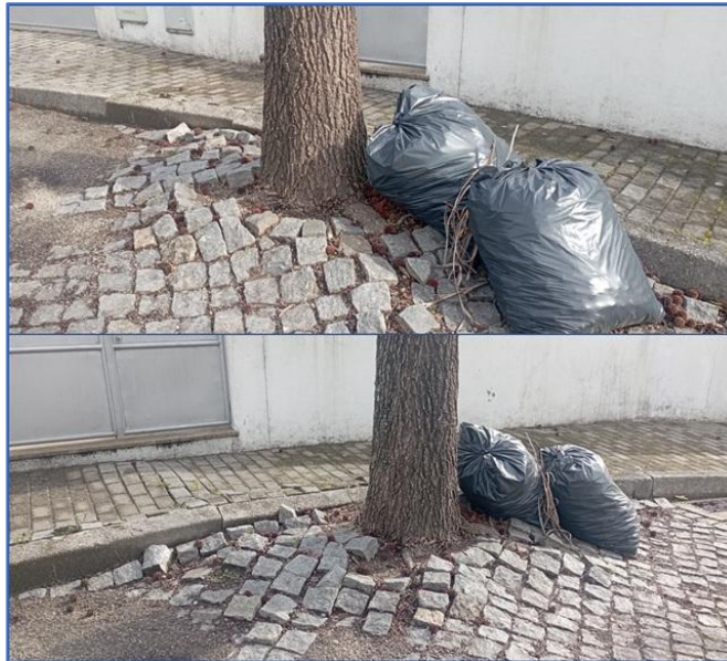
Figura 24 – Imagens de danos provocados pela árvore instalada no ID11
