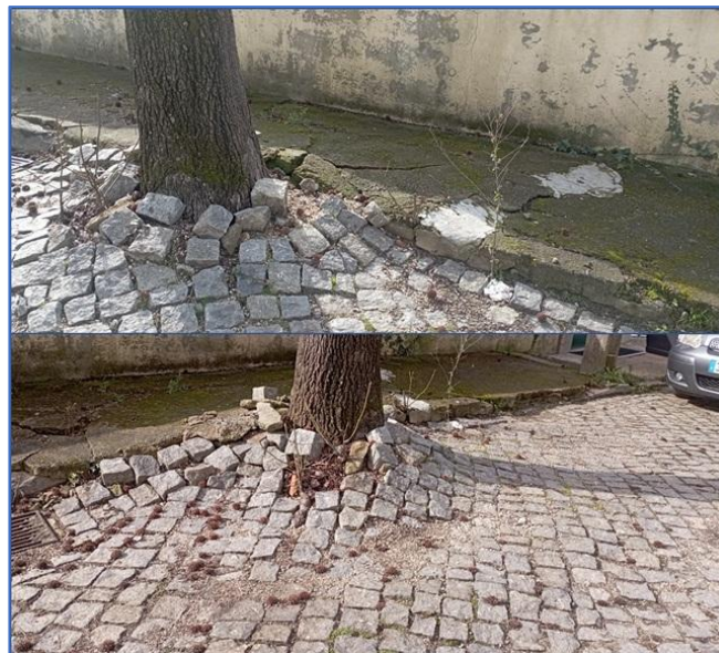
Figura 48 – Imagens de danos provocados pela árvore instalada no ID24
