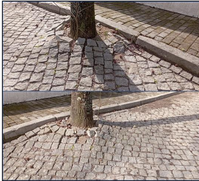
Figura 77 – Imagens de danos provocados pela árvore instalada no ID39
