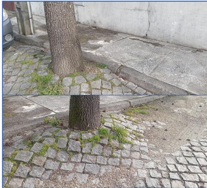
Figura 10 – Imagens de danos provocados pela árvore instalada no ID04
