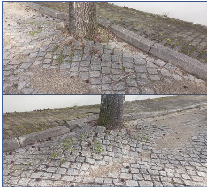
Figura 6 – Imagens de danos provocados pela árvore instalada no ID02
