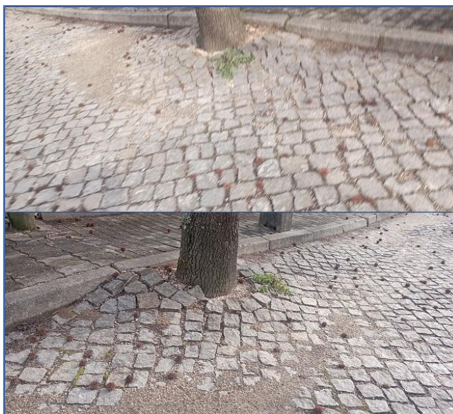
Figura 18 – Imagens de danos provocados pela árvore instalada no ID08
