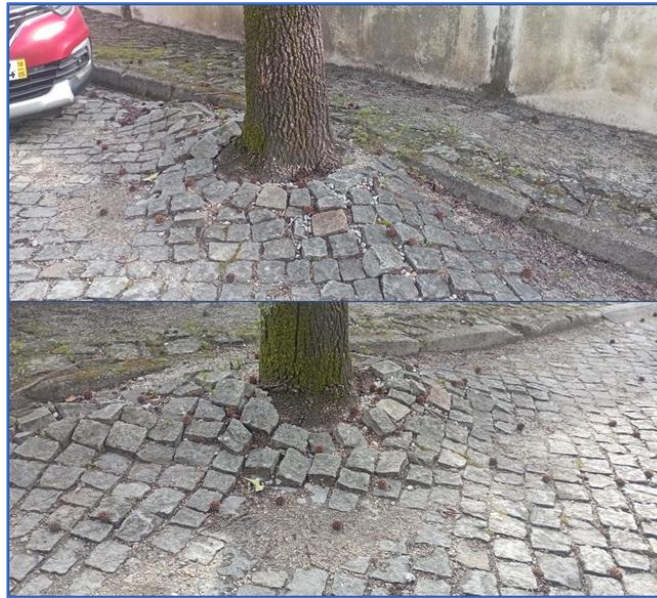
Figura 30 – Imagens de danos provocados pela árvore instalada no ID14
