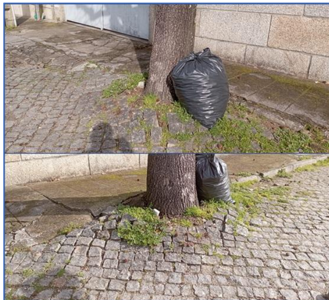
Figura 50 – Imagens de danos provocados pela árvore instalada no ID25
