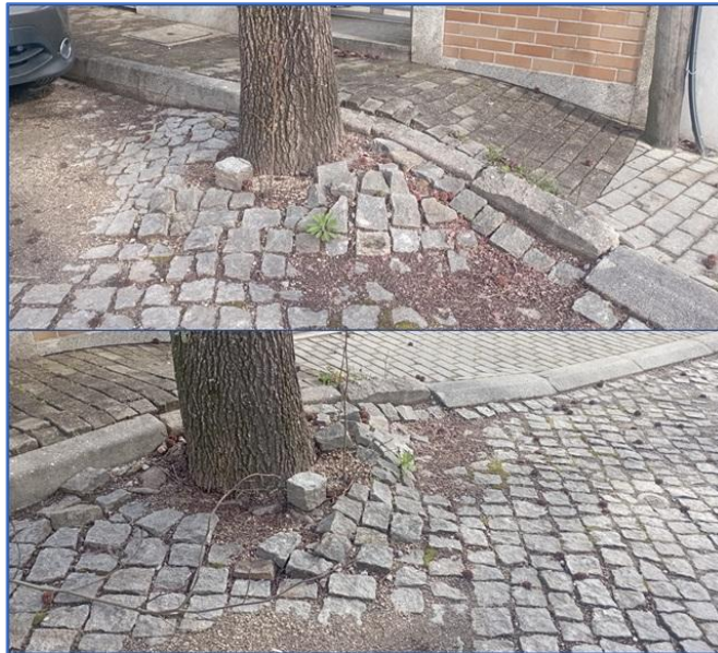
Figura 22 – Imagens de danos provocados pela árvore instalada no ID10
