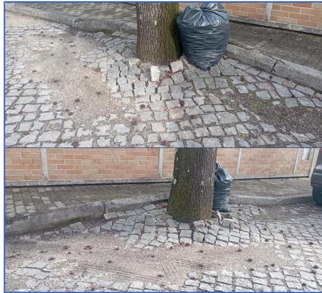
Figura 20 – Imagens de danos provocados pela árvore instalada no ID09
