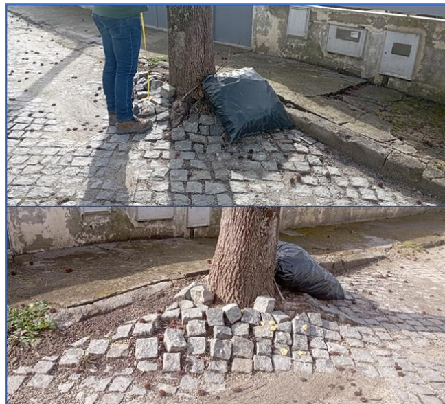
Figura 46 – Imagens de danos provocados pela árvore instalada no ID23
