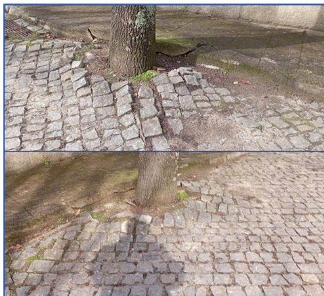
Figura 54 – Imagens de danos provocados pela árvore instalada no ID27
