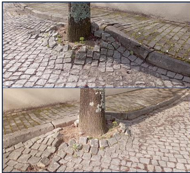
Figura 71 – Imagens de danos provocados pela árvore instalada no ID36
