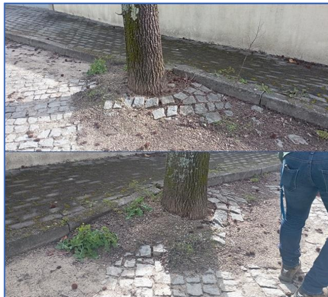
Figura 38 – Imagens de danos provocados pela árvore instalada no ID19
