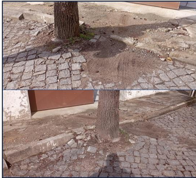
Figura 63 – Imagens de danos provocados pela árvore instalada no ID32
