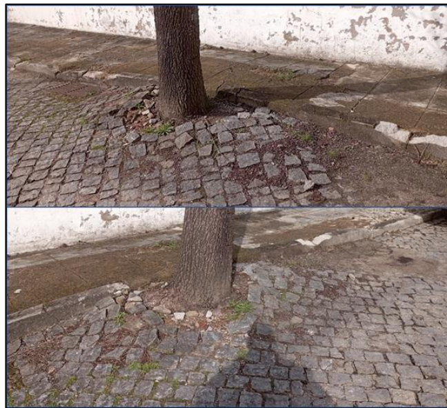
Figura 61 – Imagens de danos provocados pela árvore instalada no ID31
