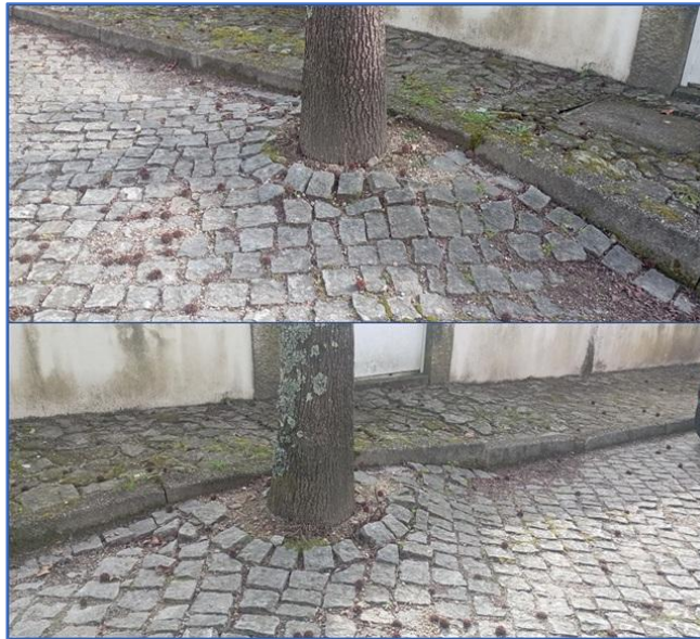
Figura 28 – Imagens de danos provocados pela árvore instalada no ID13
