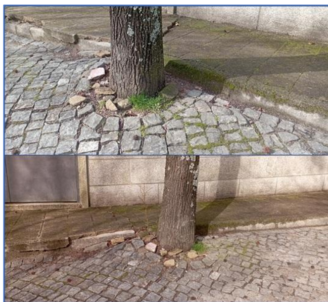
Figura 56 – Imagens de danos provocados pela árvore instalada no ID28
