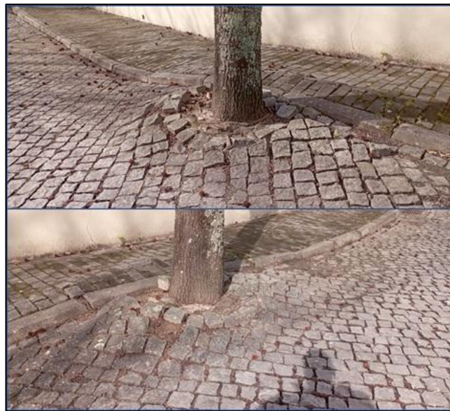
Figura 69 – Imagens de danos provocados pela árvore instalada no ID35
