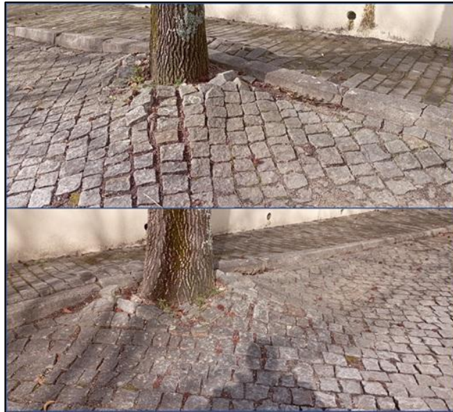
Figura 67 – Imagens de danos provocados pela árvore instalada no ID34
