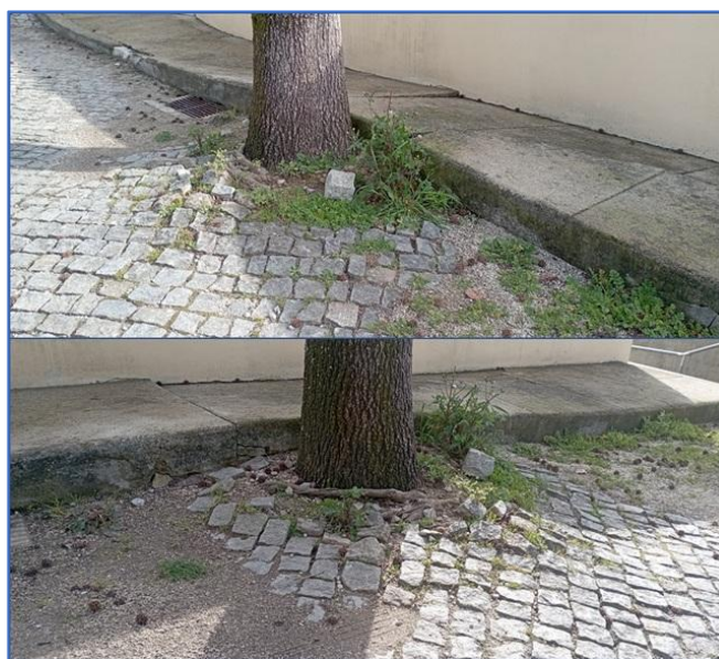
Figura 44 – Imagens de danos provocados pela árvore instalada no ID22
