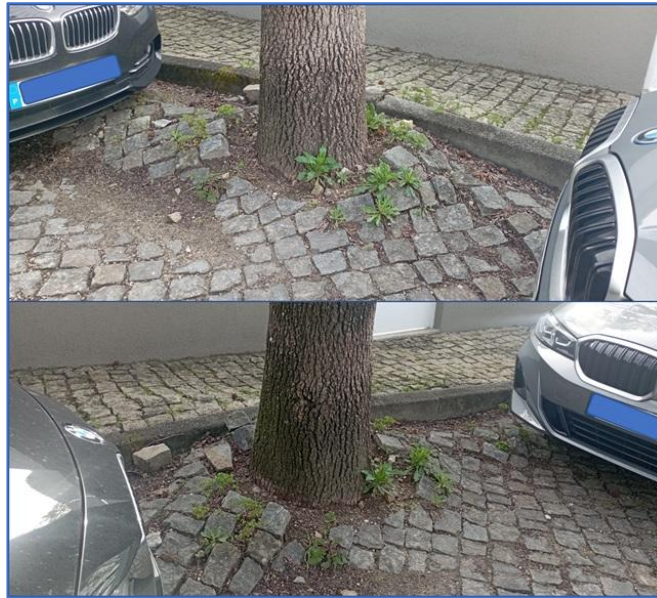
Figura 34 – Imagens de danos provocados pela árvore instalada no ID16
