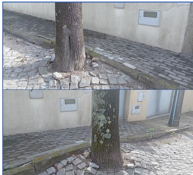
Figura 40 – Imagens de danos provocados pela árvore instalada no ID20
