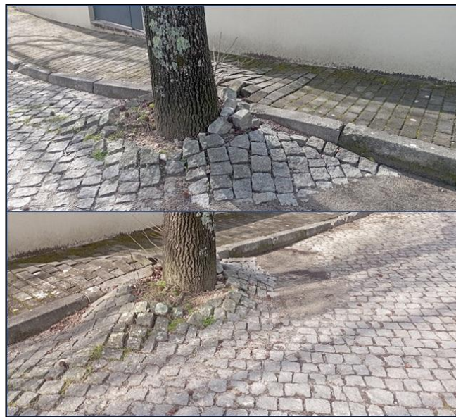
Figura 73 – Imagens de danos provocados pela árvore instalada no ID37
