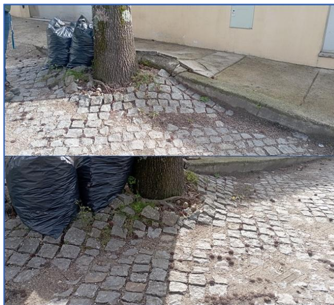
Figura 42 – Imagens de danos provocados pela árvore instalada no ID21
