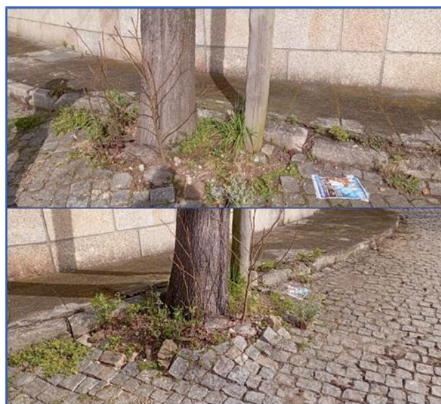
Figura 52 – Imagens de danos provocados pela árvore instalada no ID26
