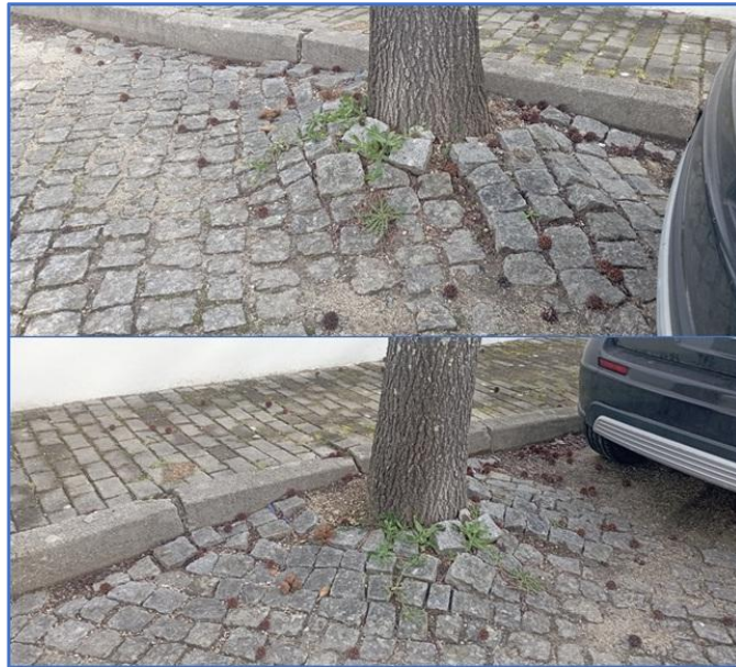
Figura 4 – Imagens de danos provocados pela árvore instalada no ID01
