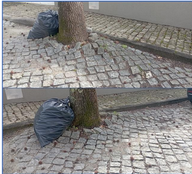
Figura 32 – Imagens de danos provocados pela árvore instalada no ID15
