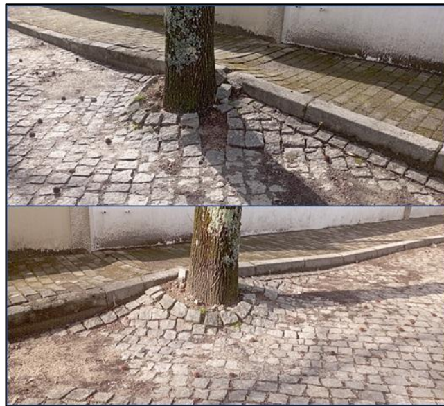
Figura 75 – Imagens de danos provocados pela árvore instalada no ID38
