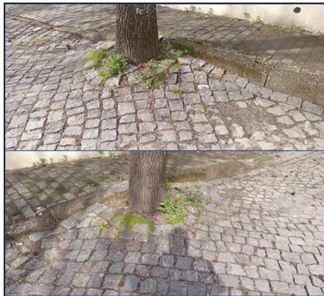
Figura 65 – Imagens de danos provocados pela árvore instalada no ID33
