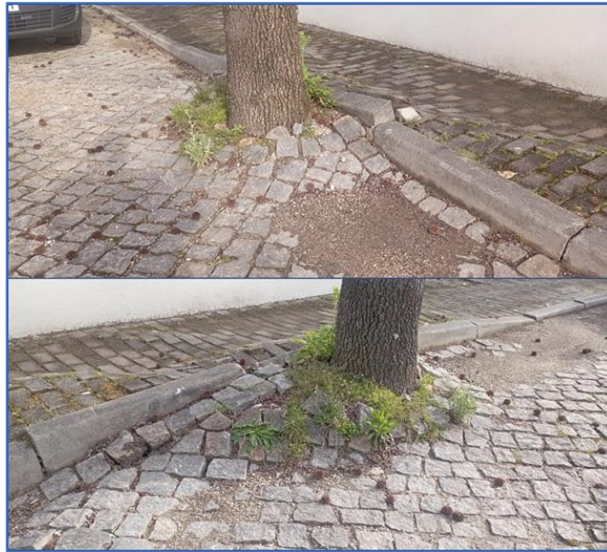
Figura 8 – Imagens de danos provocados pela árvore instalada no ID03
