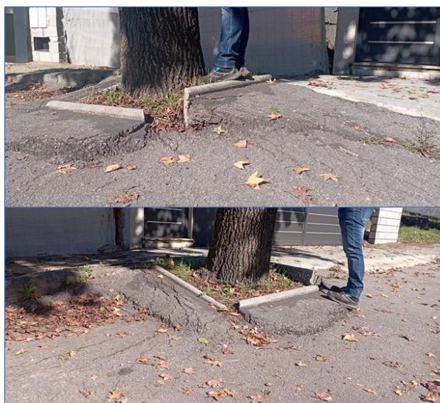
Figura 9 – Imagens de danos provocados pela árvore instalada no ID04
