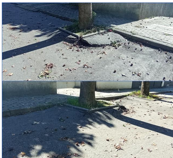
Figura 31 – Imagens de danos provocados pela árvore instalada no ID17
