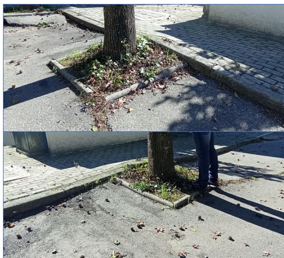
Figura 33 – Imagens de danos provocados pela árvore instalada no ID18
