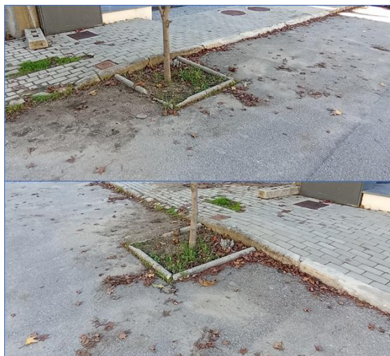
Figura 36 – Imagens de danos provocados pela árvore instalada no ID20
