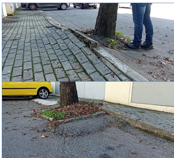
Figura 25 – Imagens de danos provocados pela árvore instalada no ID13
