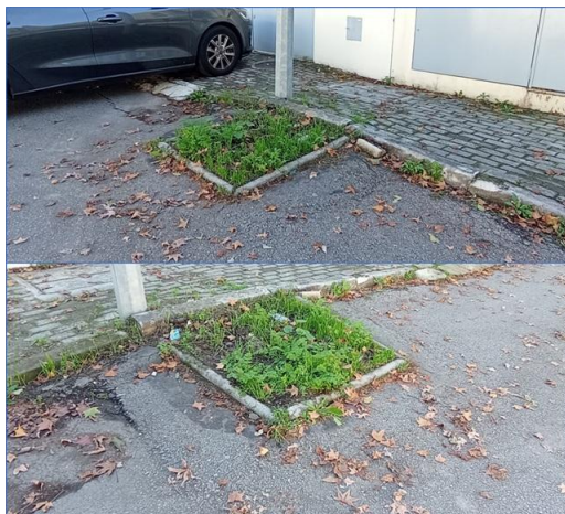
Figura 26 – Imagens da caldeira ID14
