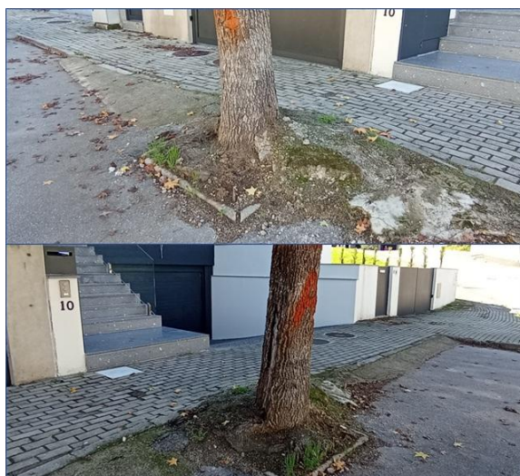
Figura 39 – Imagens de danos provocados pela árvore instalada no ID22
