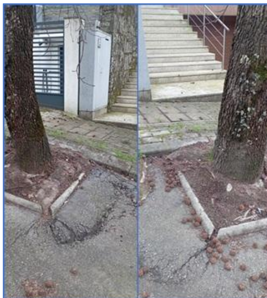
Figura 29 – Imagens de danos provocados junto à caldeira do ID18
