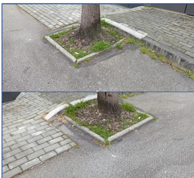
Figura 64 – Imagens de danos provocados junto à caldeira do ID38
