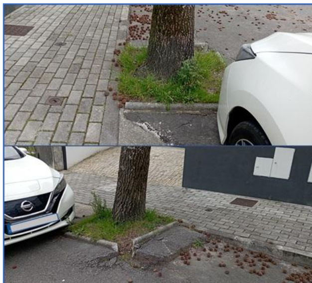
Figura 49 – Imagens de danos provocados junto à caldeira do ID29
