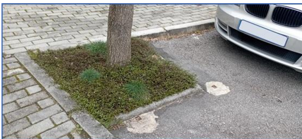
Figura 66 – Imagens de danos provocados junto à caldeira do ID39
