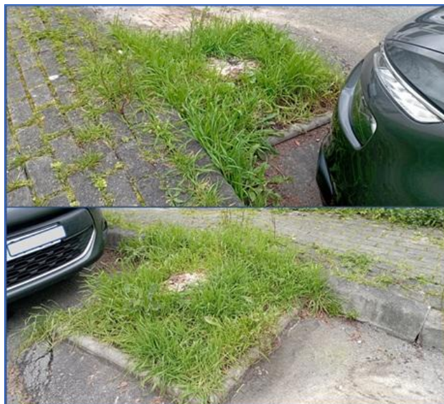
Figura 55 – Imagens do enquadramento da caldeira do ID33
