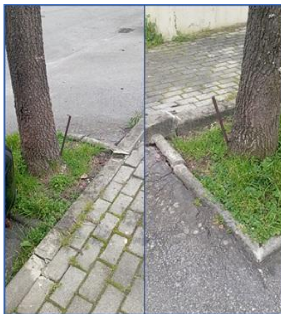
Figura 9 – Imagens de danos provocados pela árvore instalada no ID05
