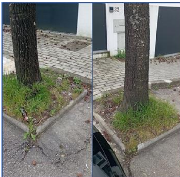
Figura 15 – Imagens de danos provocados pela árvore instalada no ID09
