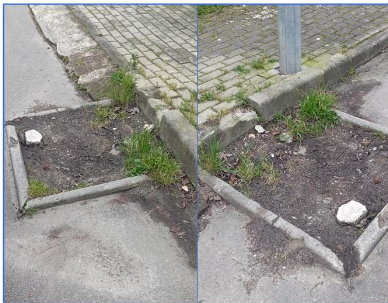
Figura 5 – Imagens do enquadramento da caldeira do ID02
