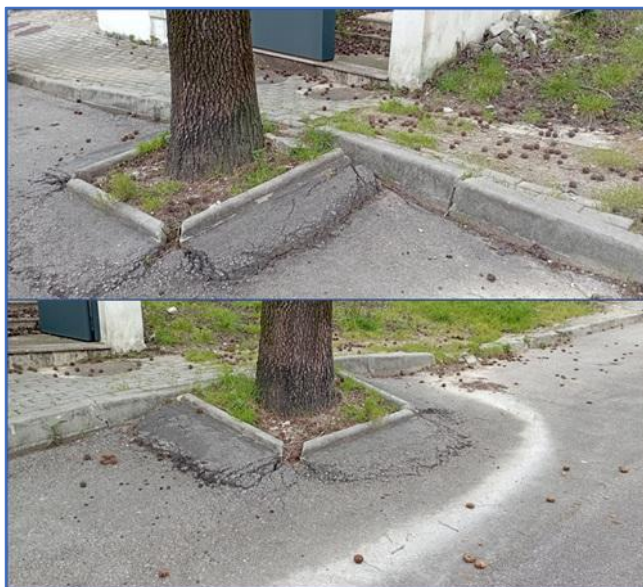
Figura 51 – Imagens de danos provocados junto à caldeira do ID30
