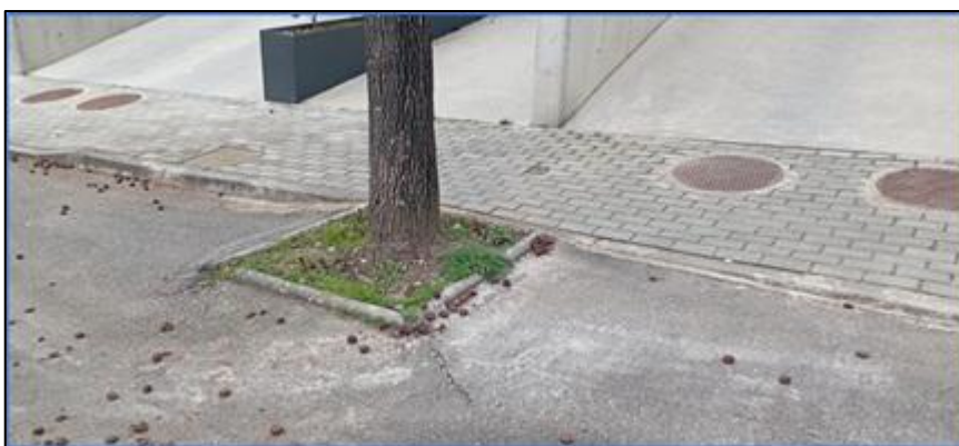
Figura 36 – Imagens de danos provocados junto à caldeira do ID22
