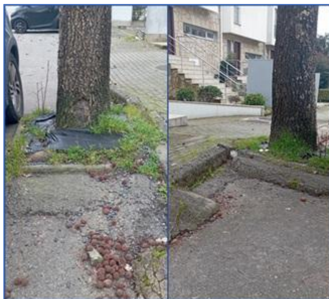
Figura 23 – Imagens de danos provocados pela árvore instalada no ID14
