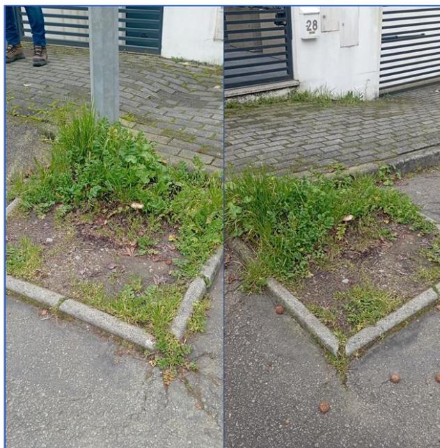
Figura 13 – Imagens do enquadramento da caldeira do ID08
