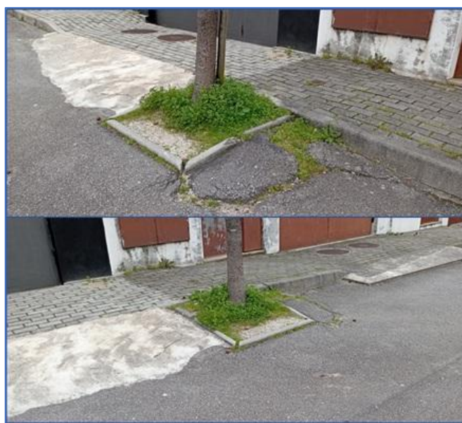
Figura 62 – Imagens de danos provocados junto à caldeira do ID37
