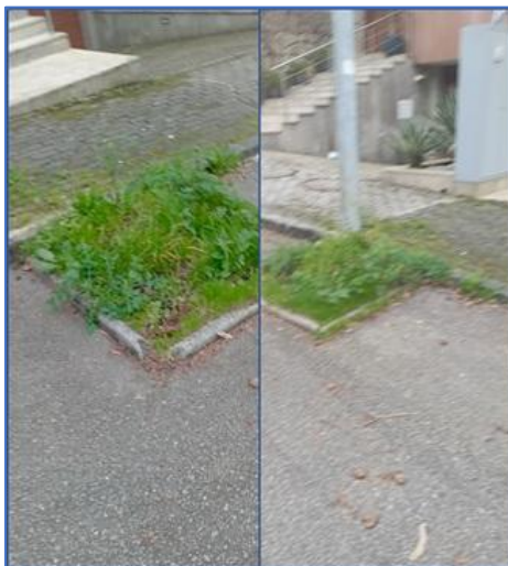
Figura 27 – Imagens do enquadramento da caldeira do ID17
