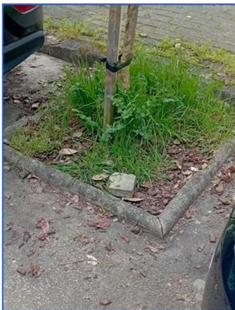
Figura 11 – Imagens da caldeira do ID06
