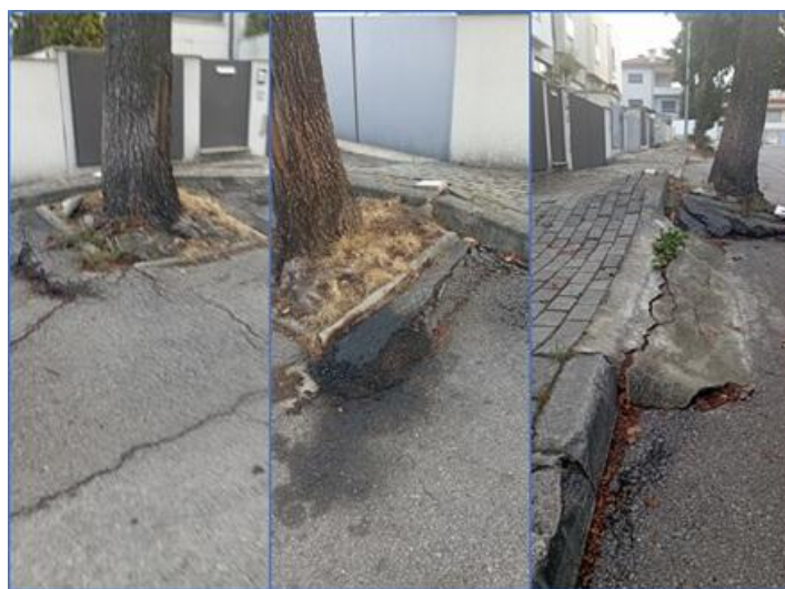
Figura 17 – Imagens de danos provocados pela árvore instalada no ID08
