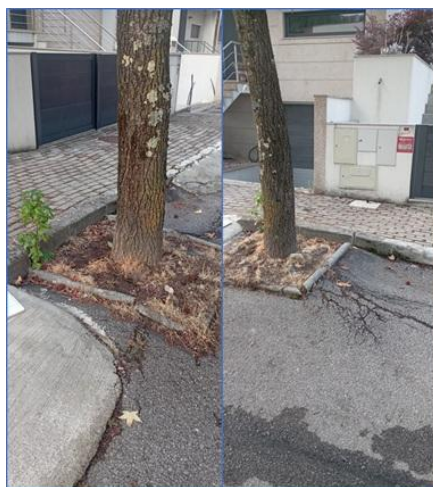
Figura 7 – Imagens de danos provocados pela árvore instalada no ID03
