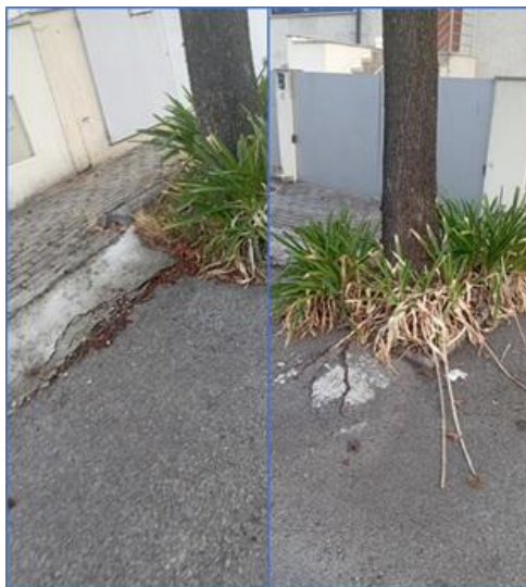
Figura 9 – Imagens de danos provocados pela árvore instalada no ID04
