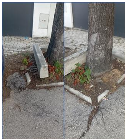
Figura 27 – Imagens de danos provocados pela árvore instalada no ID14
