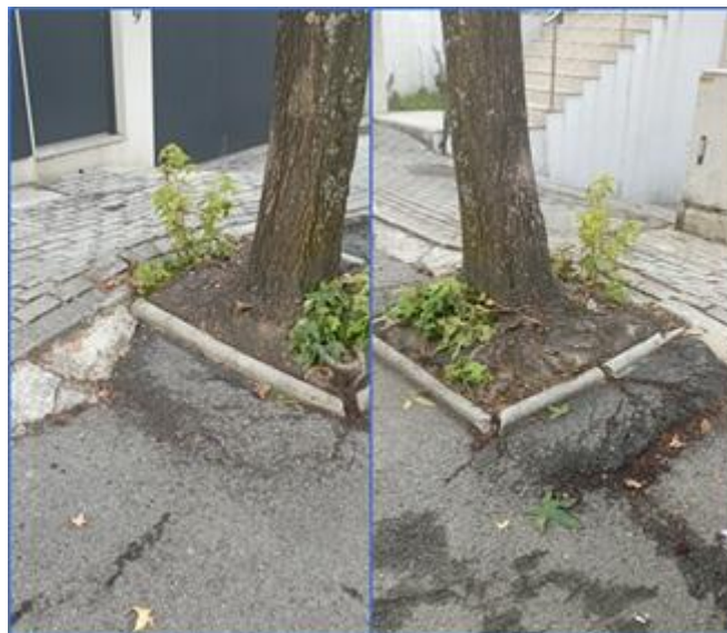
Figura 11 – Imagens de danos provocados pela árvore instalada no ID05
