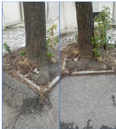
Figura 15 – Imagens de danos provocados pela árvore instalada no ID07
