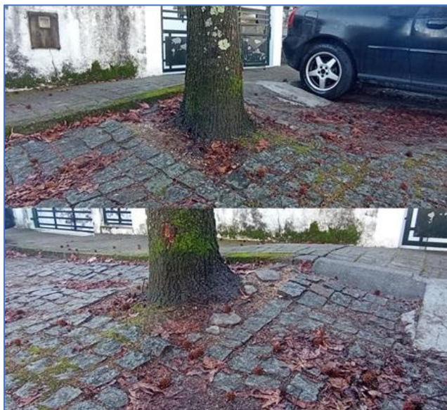
Figura 13 – Imagens de danos provocados pela árvore instalada no ID06
