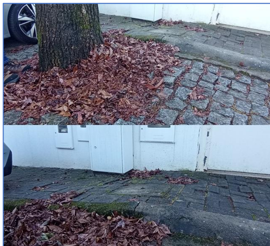
Figura 7 – Imagens de danos provocados pela árvore instalada no ID03
