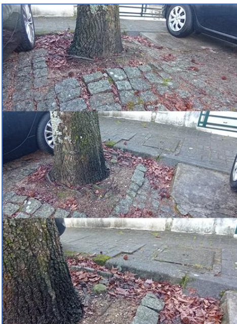
Figura 11 – Imagens de danos provocados pela árvore instalada no ID05
