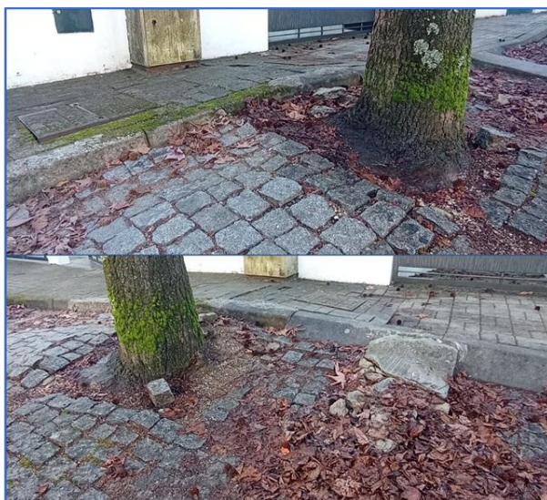
Figura 15 – Imagens de danos provocados pela árvore instalada no ID07
