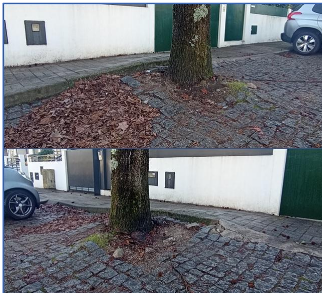
Figura 17 – Imagens de danos provocados pela árvore instalada no ID08
