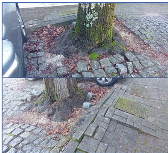
Figura 19 – Imagens de danos provocados pela árvore instalada no ID09
