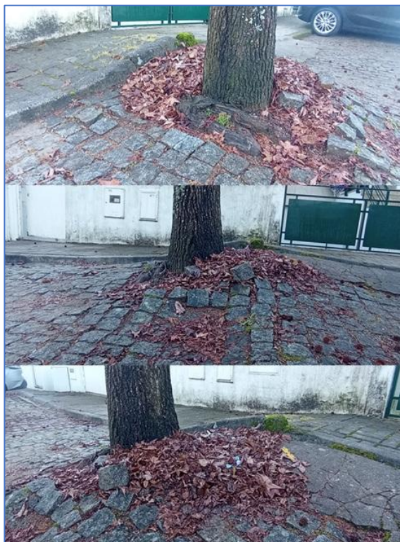
Figura 9 – Imagens de danos provocados pela árvore instalada no ID04
