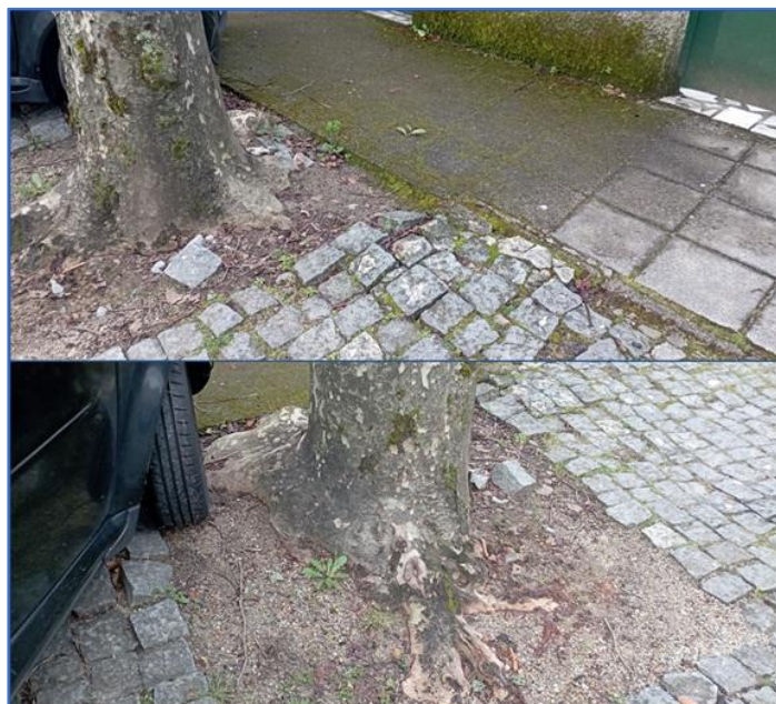
Figura 3 – Imagens da caldeira do ID15
