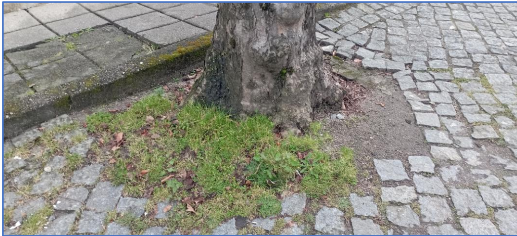
Figura 17 – Imagens da caldeira do ID06
