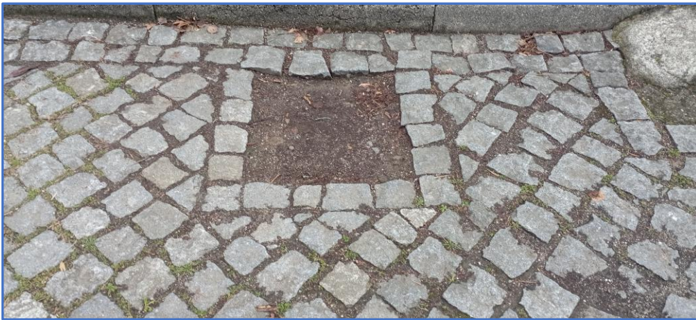
Figura 15 – Imagens do enquadramento da caldeira do ID05
