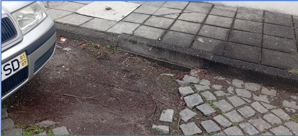
Figura 19 – Imagens do enquadramento da caldeira do ID07
