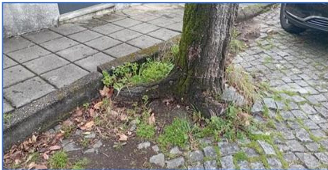
Figura 7 – Imagens da caldeira do ID02
