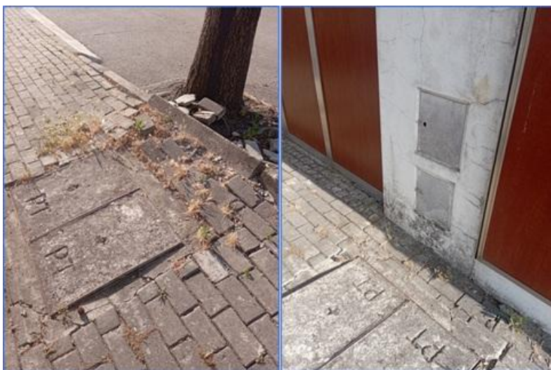
Figura 5 – Danos na caixa técnica subterrânea e no muro privado
