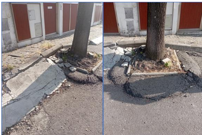
Figura 4 – Danos no pavimento do passeio pedonal e baía de estacionamento
