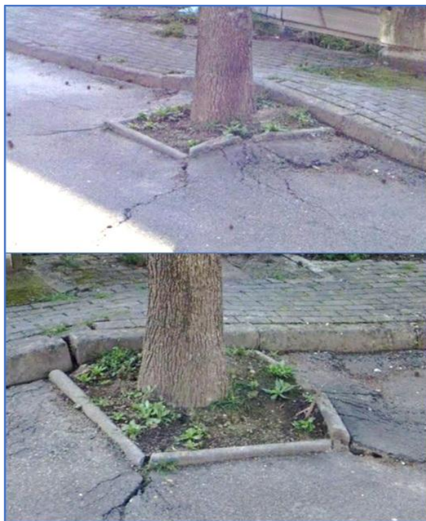
Figura 23 – Imagens de danos provocados junto à caldeira do ID13
