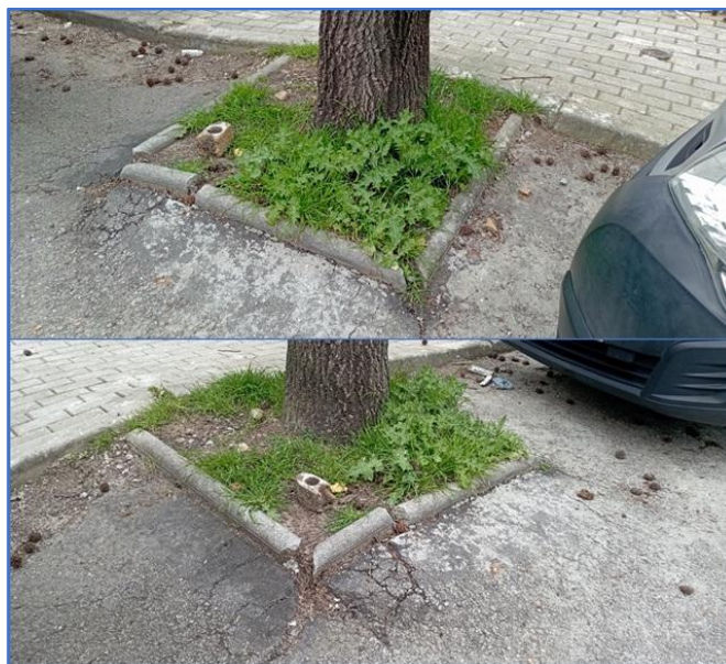
Figura 27 – Imagens de danos provocados junto à caldeira do ID16
