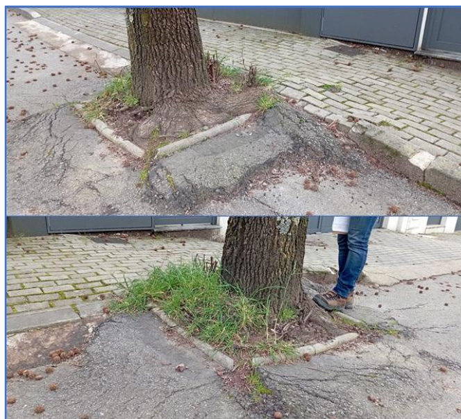
Figura 15 – Imagens de danos provocados junto à caldeira do ID08
