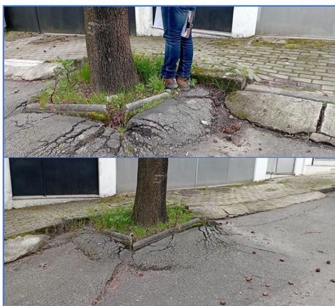
Figura 5 – Imagens de danos provocados pela árvore instalada no ID02
