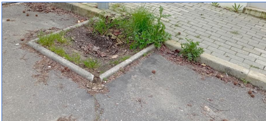
Figura 24 – Imagens do enquadramento da caldeira do ID14
