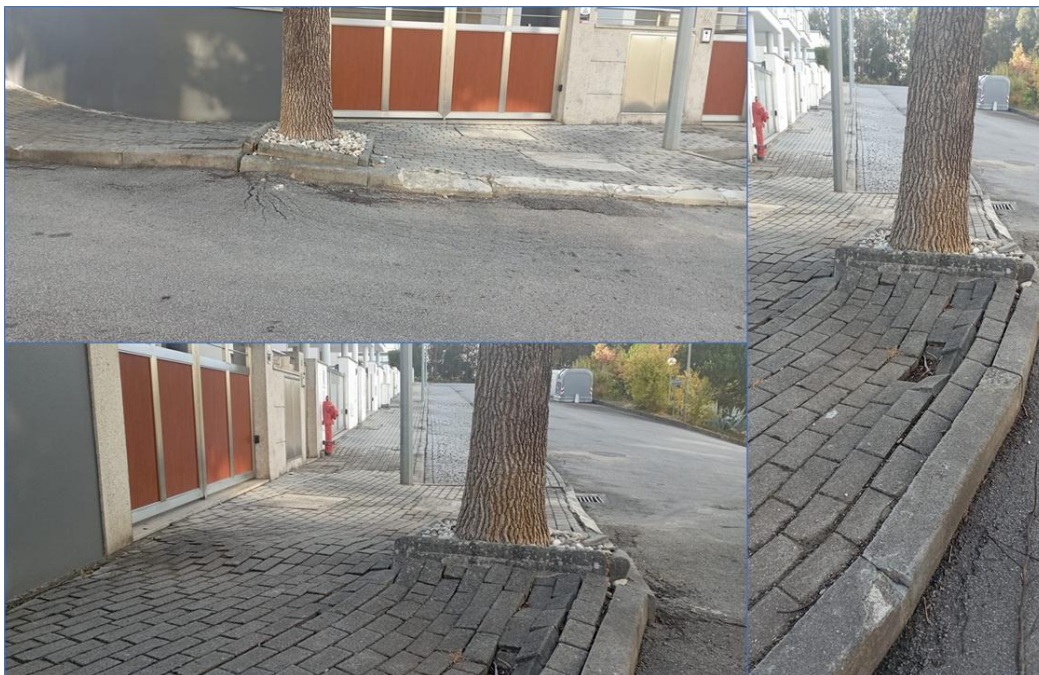
Figura 4 – Danos no pavimento do passeio pedonal e baía de estacionamento
