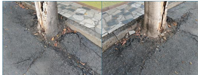
Figura 10 – Aspeto da caldeira
