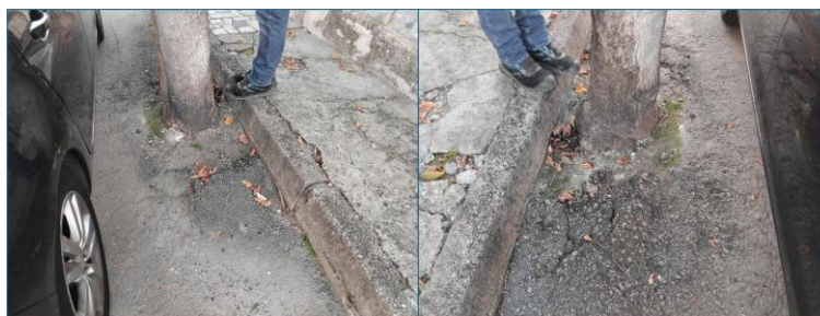
Figura 19 – Aspeto da caldeira
