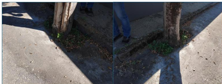
Figura 28 – Aspeto da caldeira
