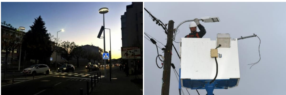
Figura 34: Iluminação pública com tecnologia LED 41
