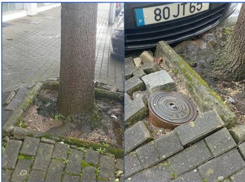
Figura 4 – Danos no passeio pedonal e conduta de gás
