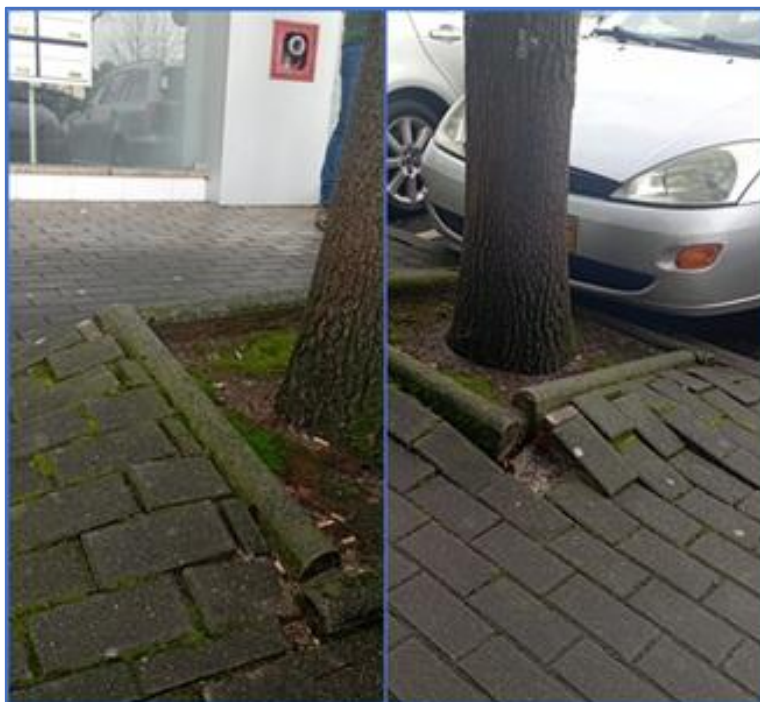
Figura 6 – Danos no passeio pedonal
