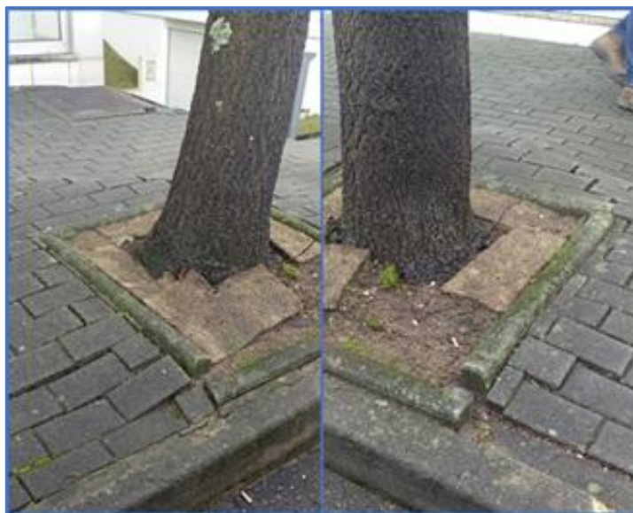
Figura 8 – Danos no passeio pedonal
