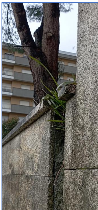
Figura 5 – Dano no muro
